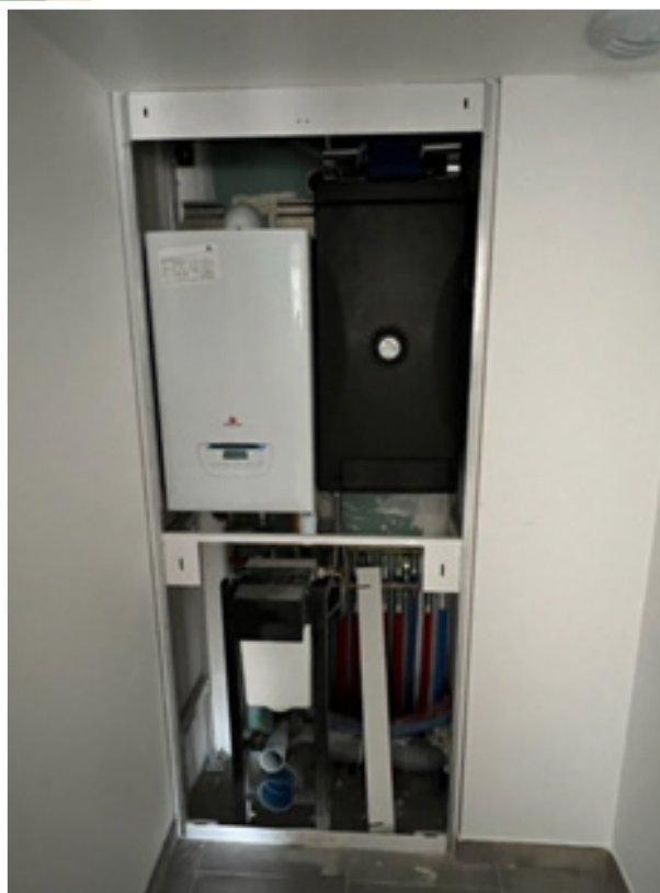
Intégration du système dans le châssis fourni
